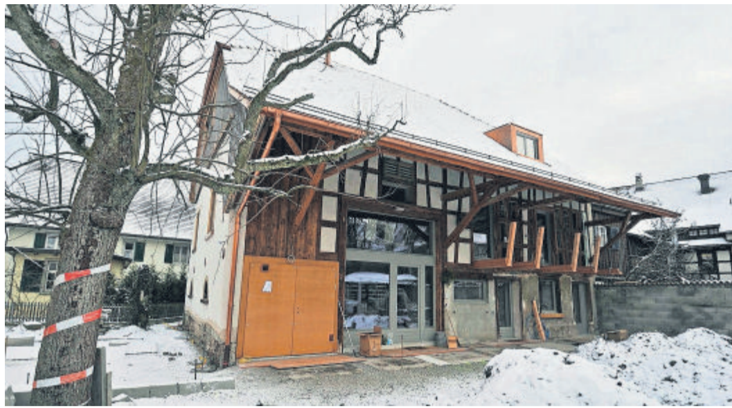
Die alte Remise während der Bauarbeiten: Nach der Umnutzung sieht sie von aussen nicht viel anders aus als vorher.
